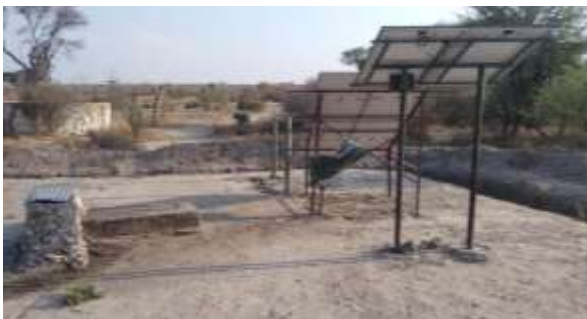
Solaranlage für die Bohrlochpumpen
