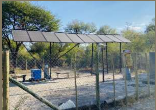
Solarpumpstation am Bohrloch 600 Meter von der Lagune entfernt
